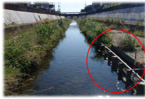
杭の裏込め材の流出
